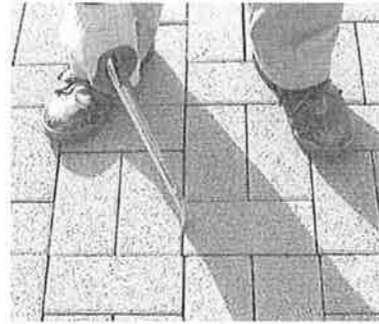
全ブロック敷設後、目地砂を充填する前にボールやマイナスドライバーなどで目地の通りを再調整します。
